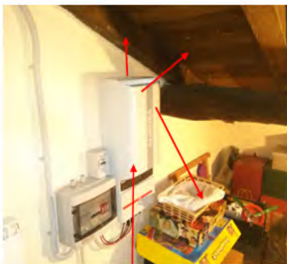
Vicinanza dell'inverter a copertura combustibile
